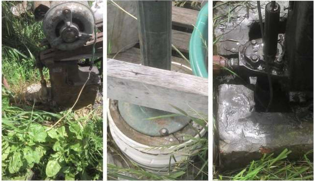
Imagen 6 Ejemplos de deficiencias constructivas que favorecen el ingreso de posibles contaminantes al pozo.
